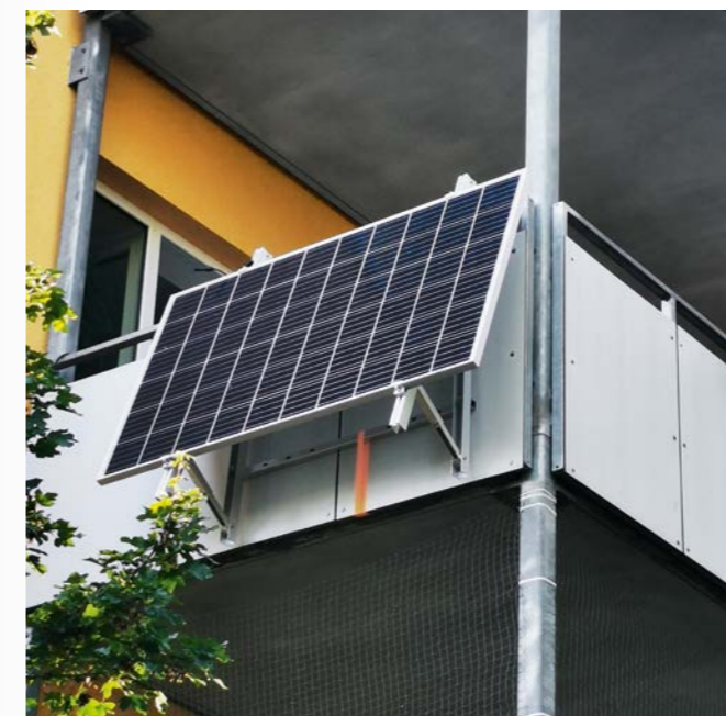
Bild links: Herr Beckmanns montiertes Balkonkraftwerk.
